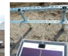
▲太陽電池との取り付け状況
